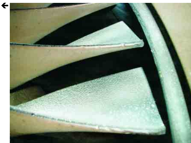
Σχ. 1. Η εξαιρετική κατάσταση των πτερυγίων του στροφείου του στροβίλου καταγράφεται σ' αυτό το σχήμα, μετά από φωτογράφιση «κλειστής απόστασης» που πάρθηκε κατά την επιθεώρηση μετά από 14.000 ώρες λειτουργίας.
